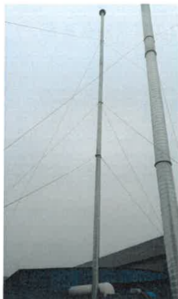
气化炉排气筒
